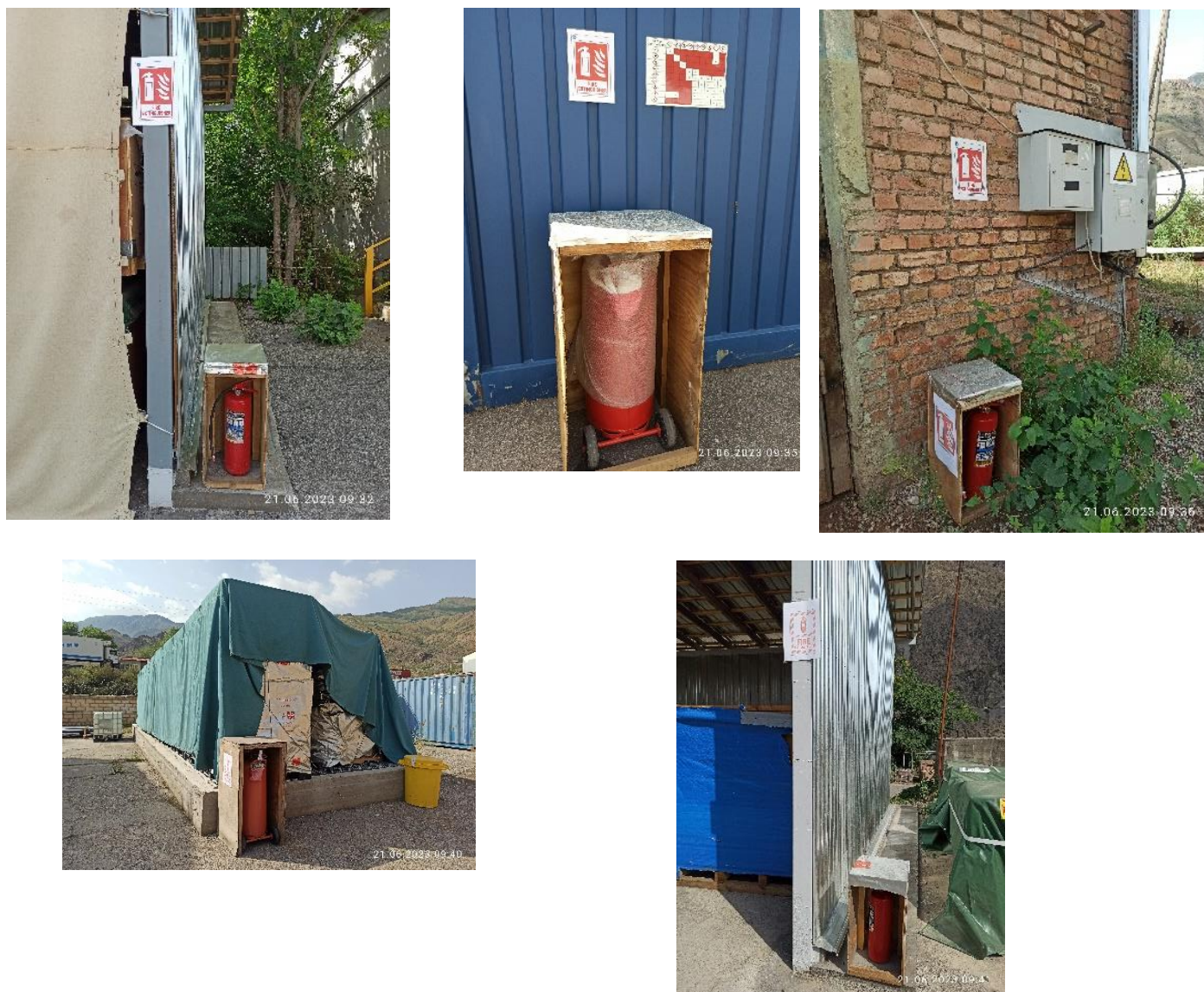
Фотография 14. Огнетушители, установленные на территории склада СП GE (статус в июне 2023 г.)
