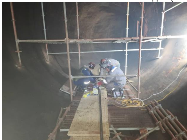
Фотография 50. Подготовительные работы к проведению пескоструйной обработки в водоводе ГА №3 (статус в апреле 2023 г.)
