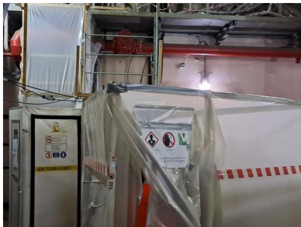
Фотография 43. Очистка асбеста с кабельной галереи системы вентиляции (статус в апреле 2023 г.)
